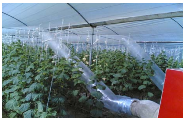
شکل ۱- انتقال هوای گرم توسط کانال‌های پلاستیکی در گلخانه Fig1- Heat transfer by plastic tubes in greenhouse
